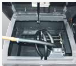
Pompe électrique de remplissage de carburant
