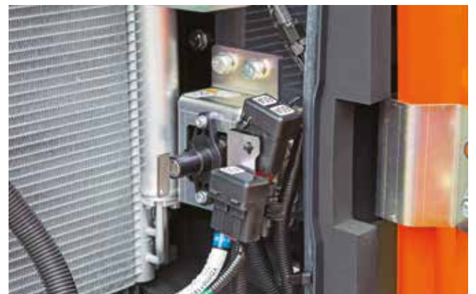
Der Batterie Hauptschalter ermöglicht die sichere Durchführung von Wartungsarbeiten.
