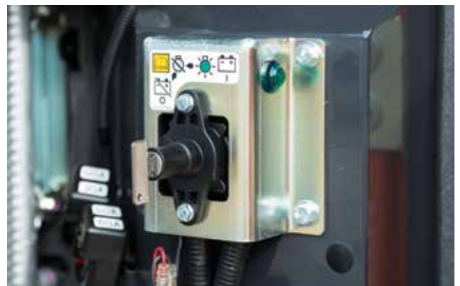
Der Batterie Hauptschalter ermöglicht die sichere Durchführung von Wartungsarbeiten.
