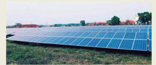
西ベンガル州にあるカラグプール工場敷地内に設置された太陽光パネル。カラグプール工場の事務棟にLEDを導入し、電力消費量と電力コストを削減しています。
