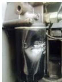
フィルタ破損状況
