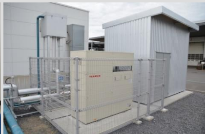
コージェネレーションシステム* (常陸那珂工場)
