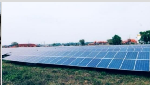
太陽光パネル (インド工場)
