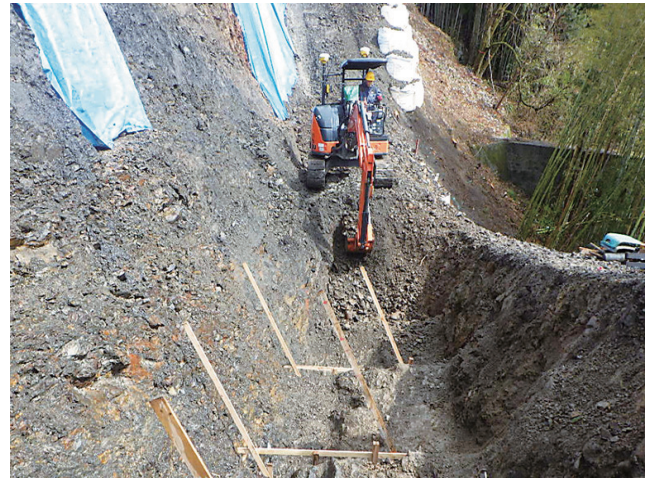
谷側の狭所で斜面を掘削し、擁壁を構築する工事用では、ミニショベルZX40Uに3次元マシンガイダンスを搭載し現場に導入。丁張設置が不要で危険箇所への立ち入りもなく工事の安全性も向上した。
